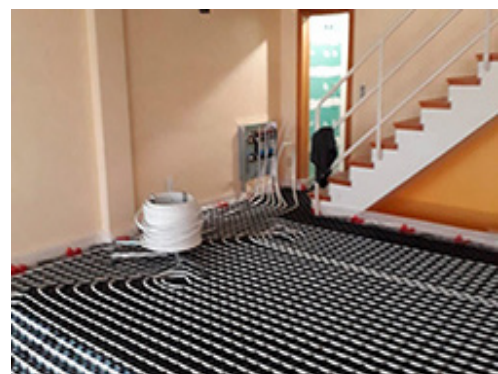
Instalación de aerotermia con fancoils en una urbanización.
