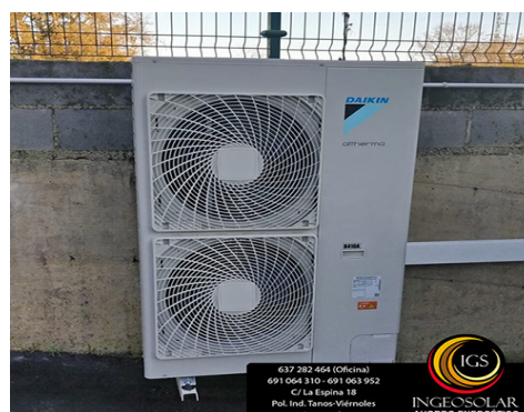
Instalación de aerotermia de alta temperatura con radiadores
