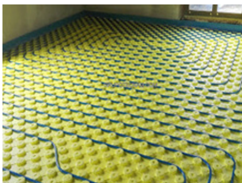
Instalación de calefacción con suelo radiante y caldera de condensación
